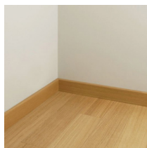
pavimentazione in legno prefinito
