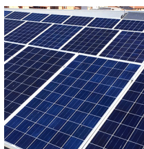
pannelli fotovoltaici in copertura
