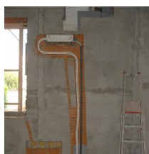
predisposizione per l'impianto di climatizzazione
