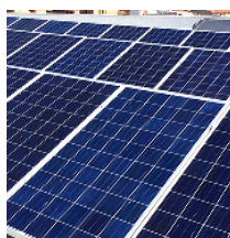
pannelli fotovoltaici in copertura
