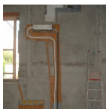
predisposizione per l'impianto di climatizzazione
